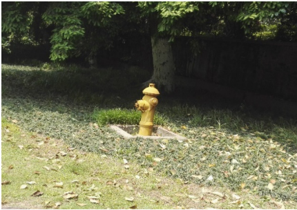
校园内现状消防栓
