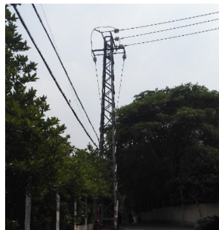
校园内现状高压线
