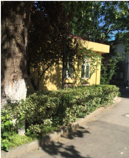
现状中低压调压站
